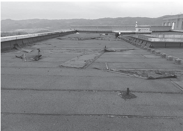
工事施行前：防水シートがめくれ上がっていました
